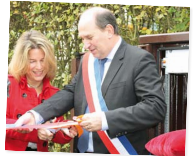
L'arrivée de la Fibre Optique permet à chaque Noiséen de se raccorder et de profiter du très haut débit
